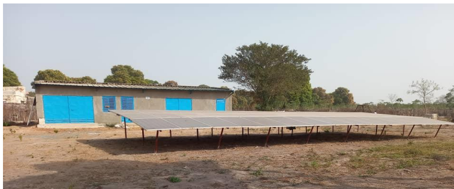
Solpaneler til pumpen og i baggrunden bygning med lager- og pumperum. Foto: COLUFIFA
